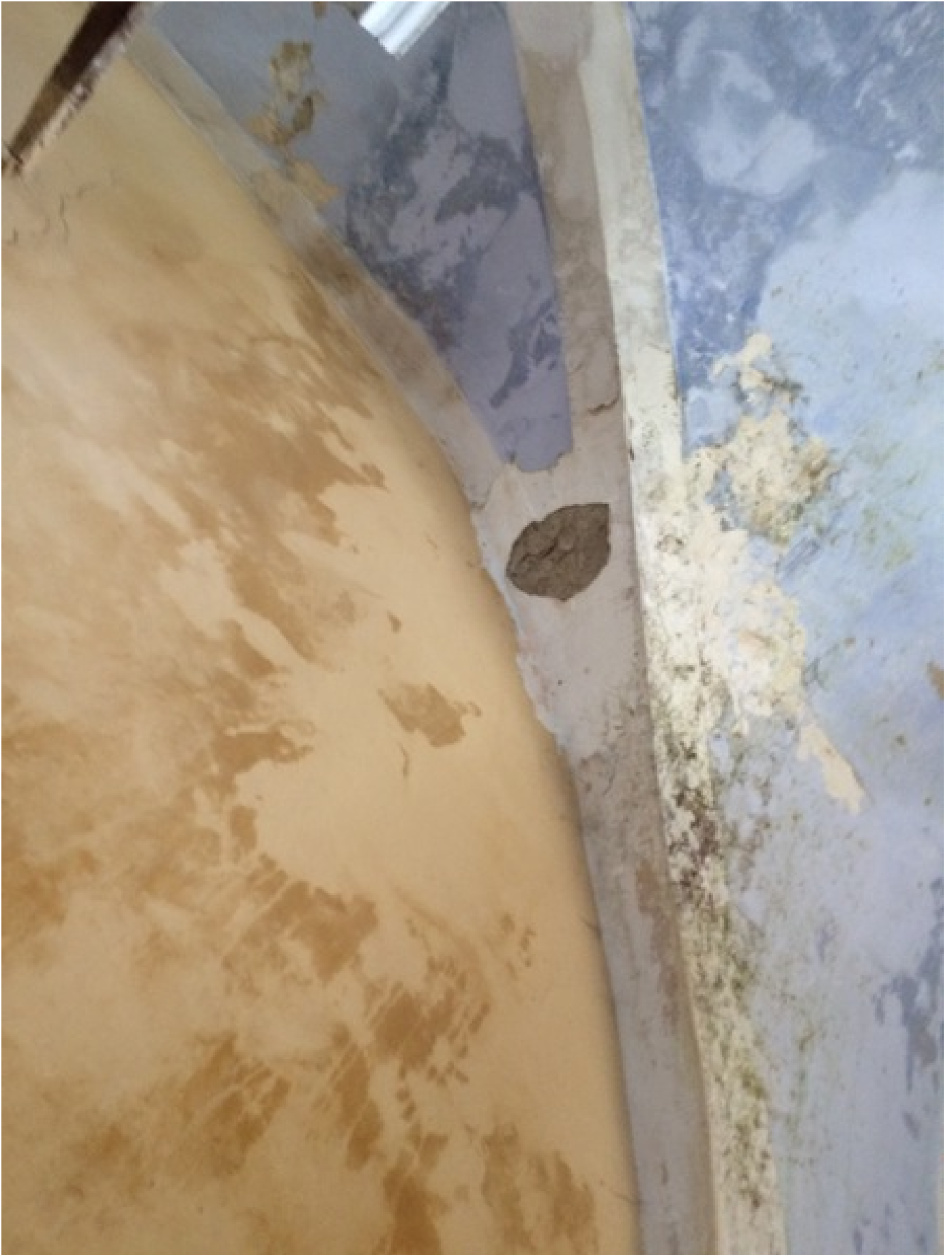
Wasserschaden an der Decke über der ORgel
