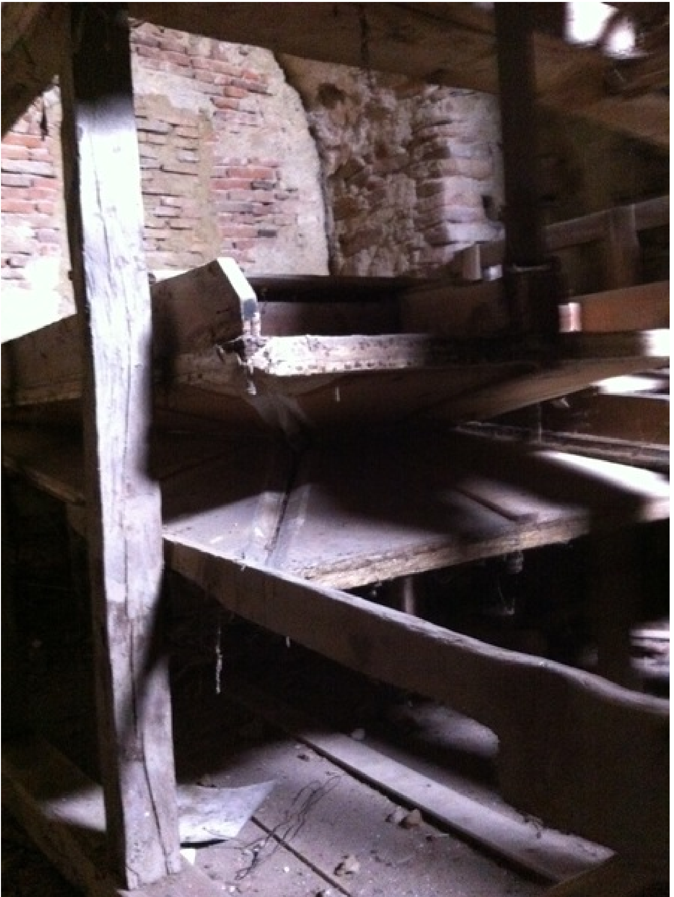
Detail 1 der originalen Balganlage im Turm hinter der Orgel (nicht angekoppelt)
