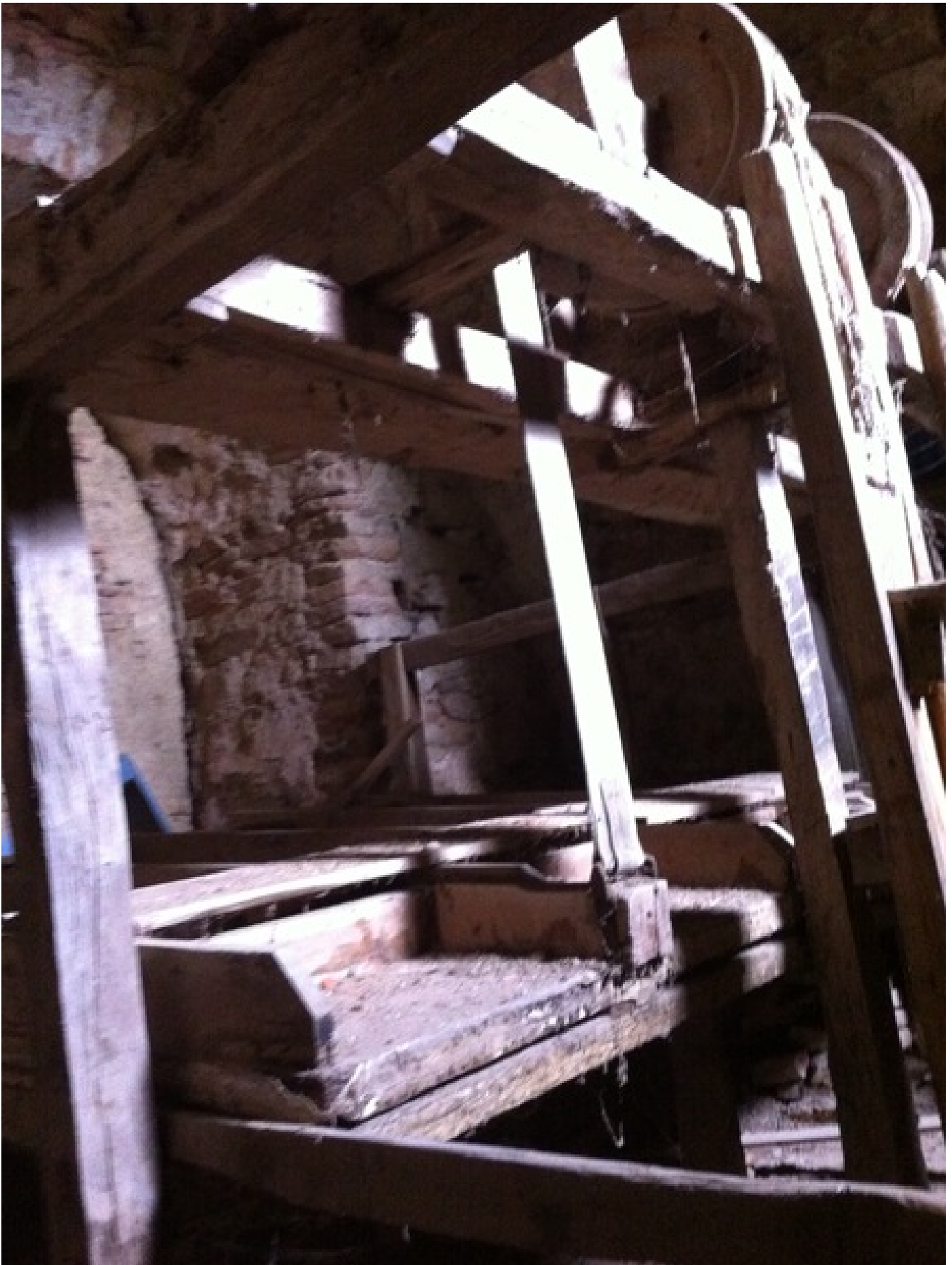
Detail 2 der originalen Balganlage im Turm hinter der Orgel (nicht angekoppelt)
