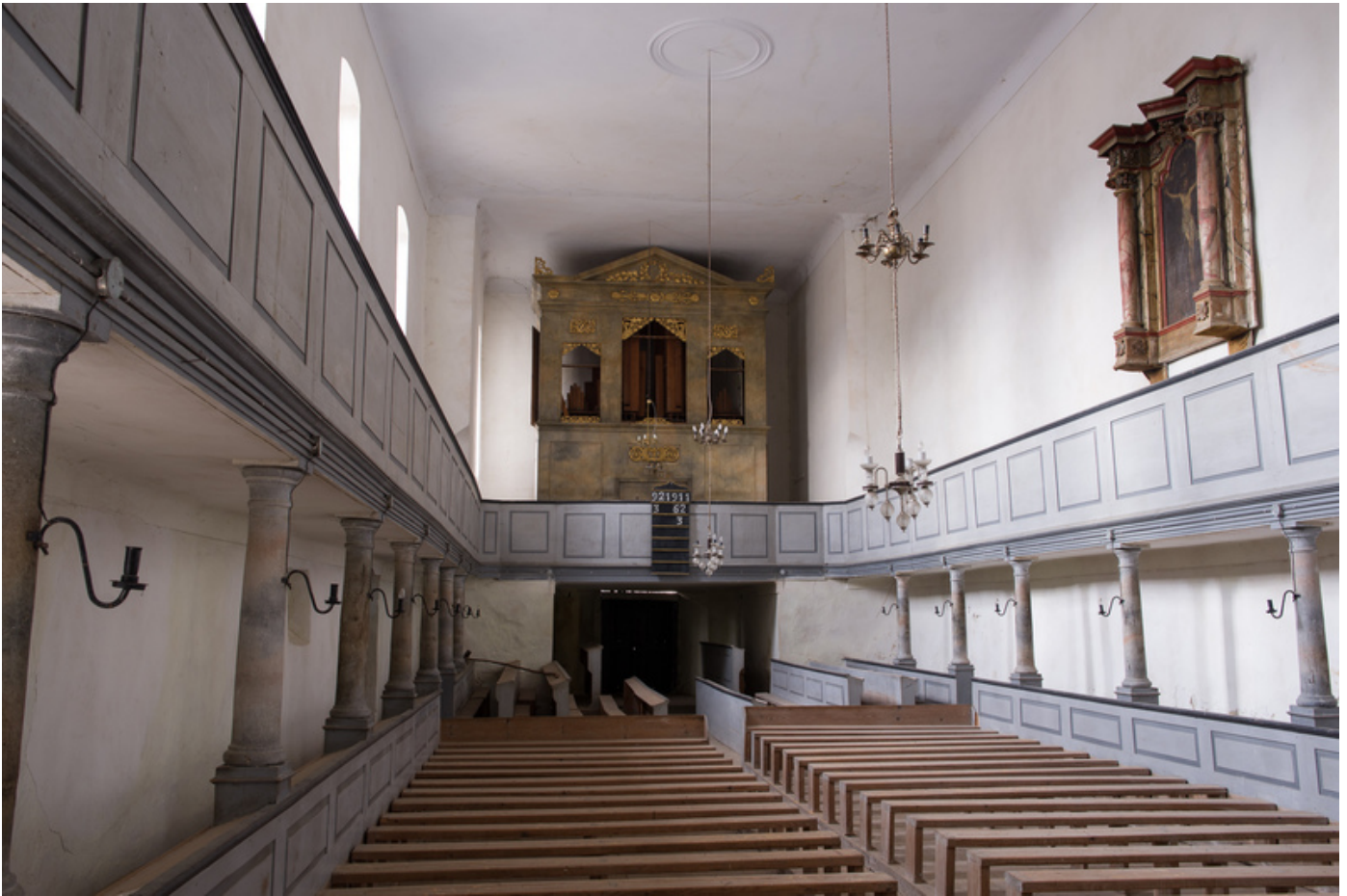
Nach dem Einbruch
