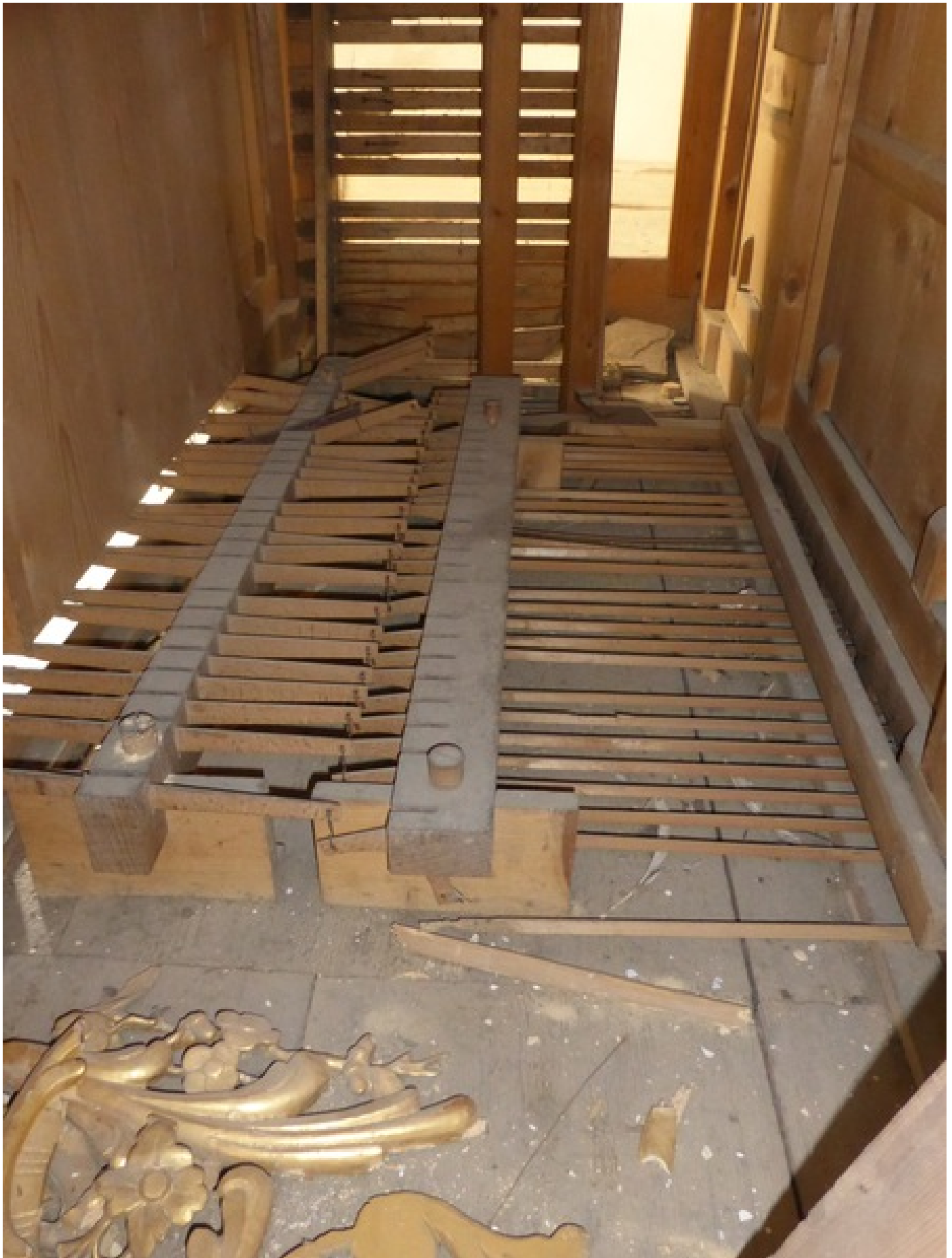
Hinten die Pedalklaviatur im Unterbau, dabb die Pedaltraktur, zuvorderst im Bild Teil der abgefallenen
