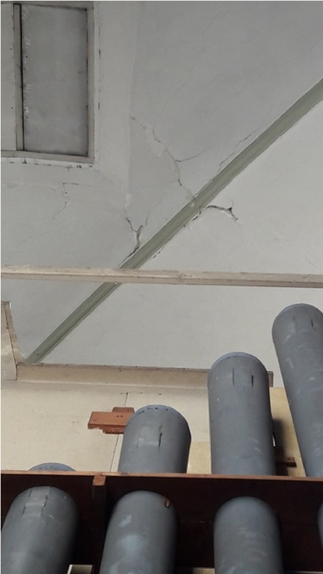
Risse an der Decke über der Orgel
