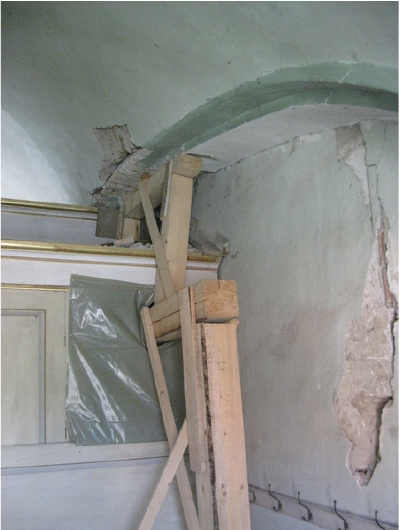
Sprung im Gewölbe über der Orgel
