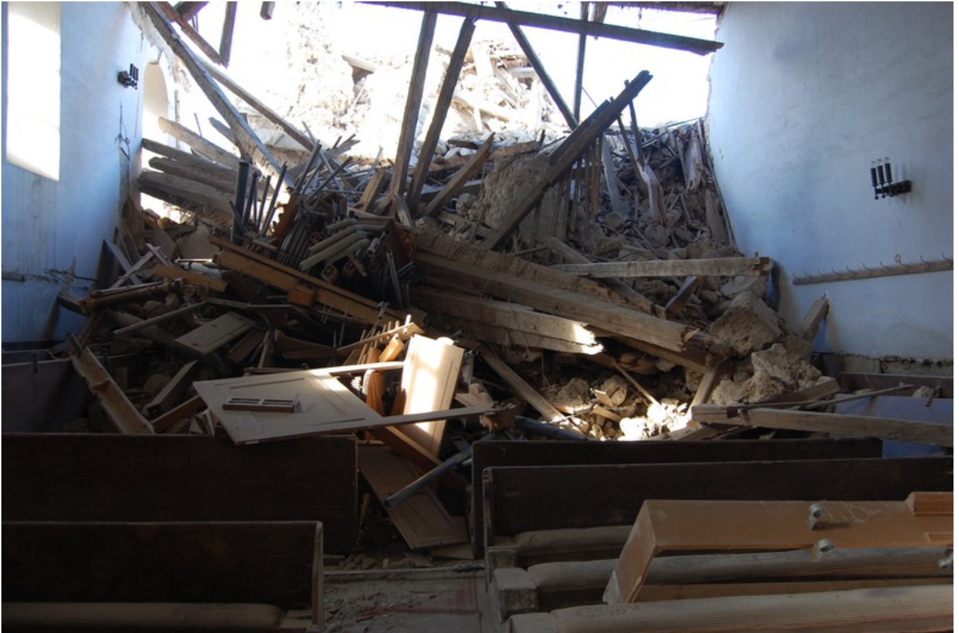
Blick vom Kirchenschiff auf die Trümmer 22. Februar 2016
