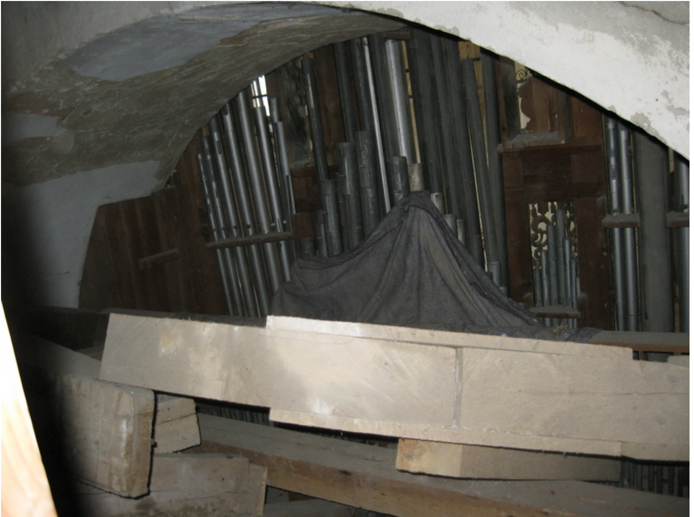
Stützkonstruktion in die Orgel gestürzt
