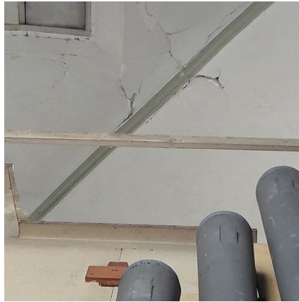
Risse an der Decke über der Orgel
