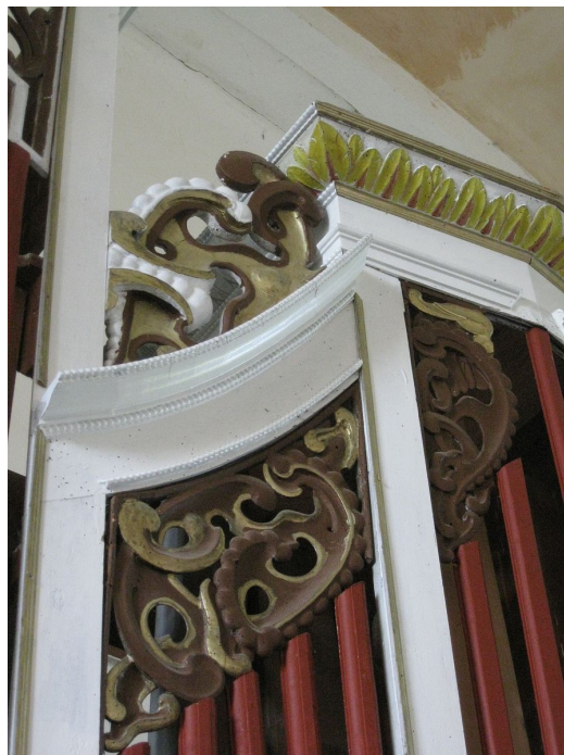
Schleierbretter, Zustand bis 2022
