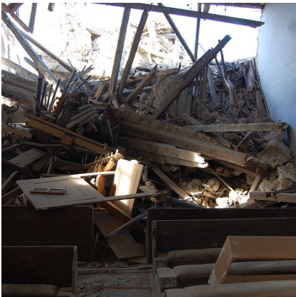
Blick vom Kirchenschiff auf die Trümmer 22. Februar 2016
