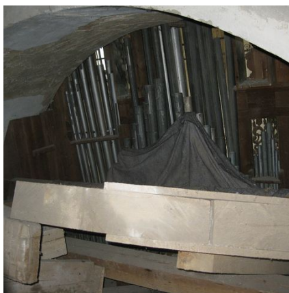
Stützkonstruktion in die Orgel gestürzt
