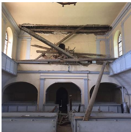
Zustand nach Zusammensturz der Decke über der Orgel Ende Juni. <br/> EIN Glück: Keine Menschen kamen dabei zu Schaden
