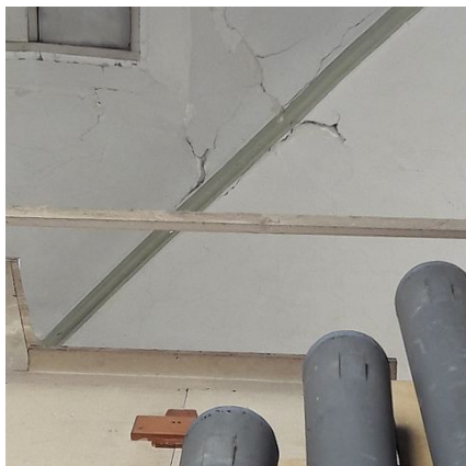
Risse an der Decke über der Orgel
